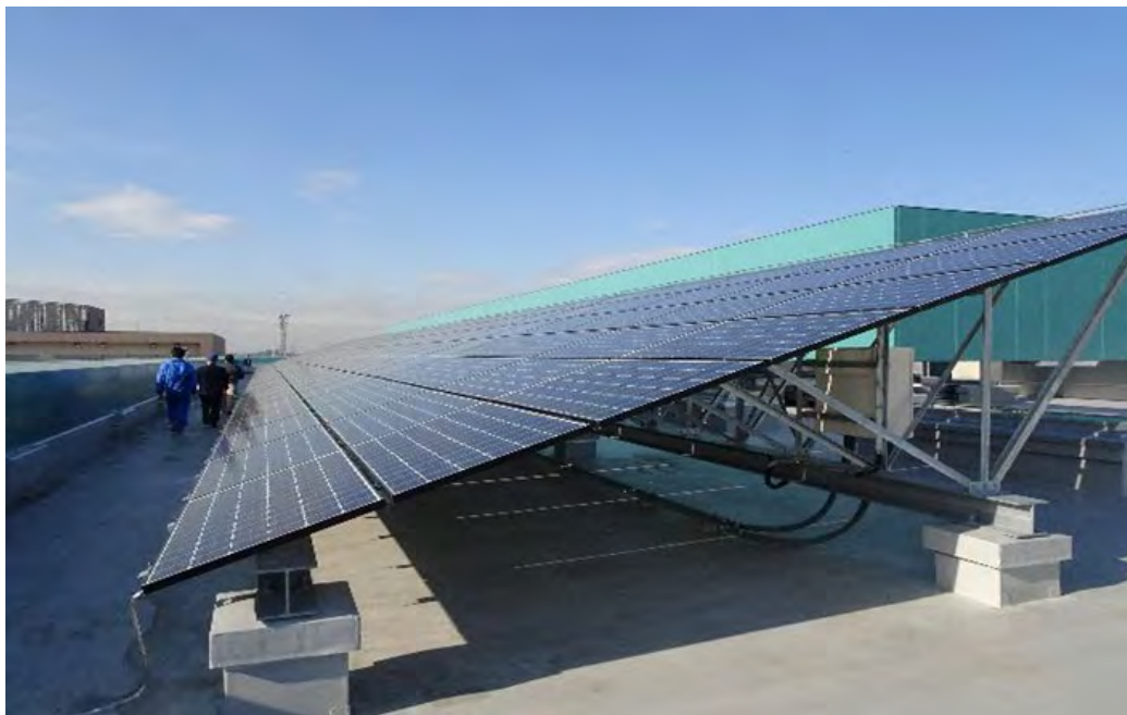
屋上に設置されたソーラーパネル
