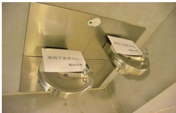
給水機は使用不可
