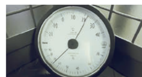
自動書庫内の温度計兼湿度計。本のためにも、空調の管理は欠かせない。ちなみに、書庫の中の空気はひんやりと涼しく保たれている。
