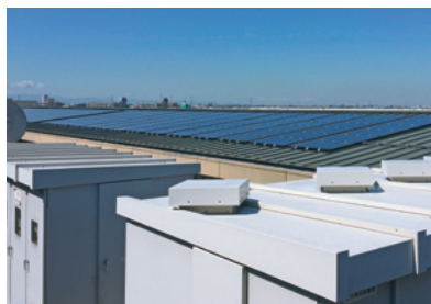
増設された太陽光発電システム
