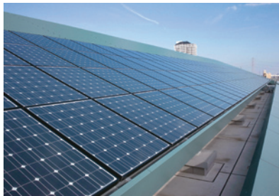
太陽光発電システム
