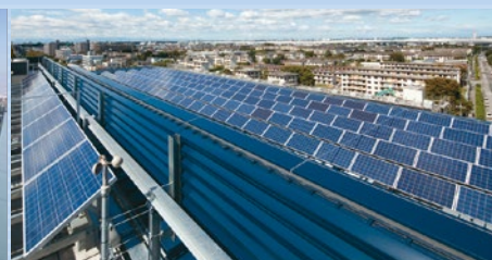
太陽光発電システム
