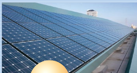
太陽光 発電システム
