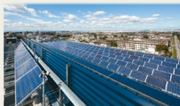
太陽光発電システム
