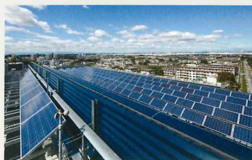
太陽光発電システム
