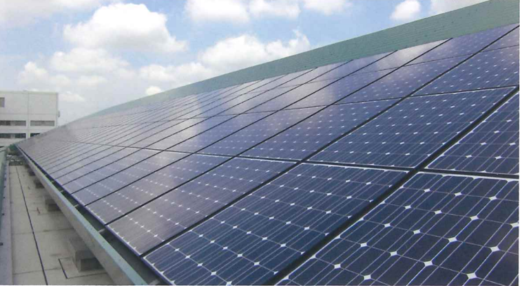
太陽光発電システム
