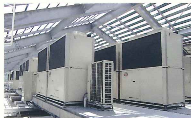
高効率発電型GHP(ガスヒートポンプ)システム
